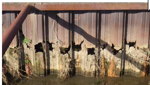
極度の腐食を受けた鋼矢板護岸
