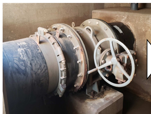
農業用パイプラインの一例
