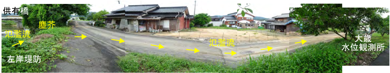
写真 2.12 吉敷川に架かる供有橋の上流の右岸堤防における塵芥の状況（3日撮影）
