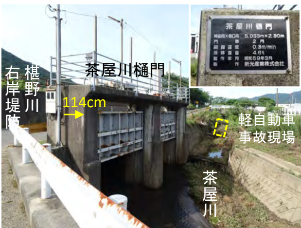
写真4.2 茶屋川樋門と軽自動車の事故現場
