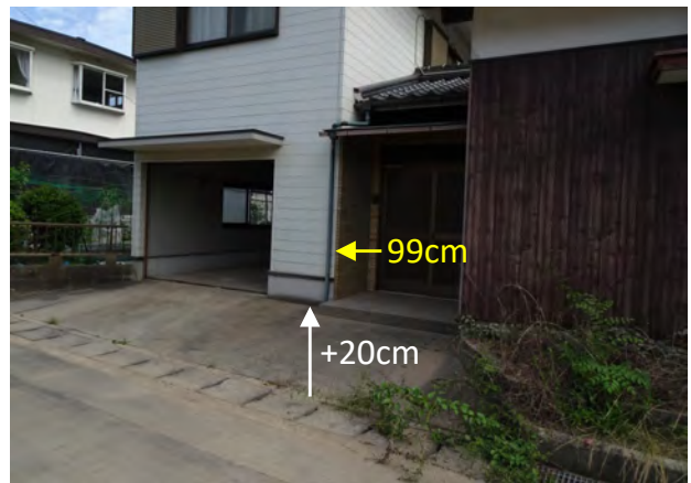
写真 3.1 下千坊地区における住宅の浸水痕跡
