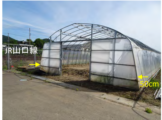
写真 4.7 農業ハウスにおける浸水痕跡
