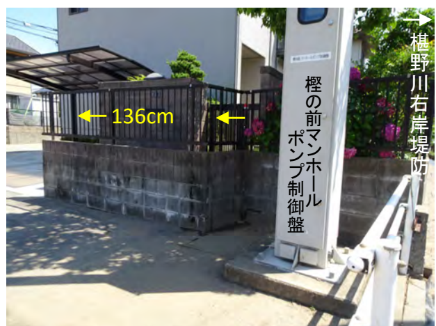
写真4.3 カーポートの浸水痕跡とポンプ制御盤
