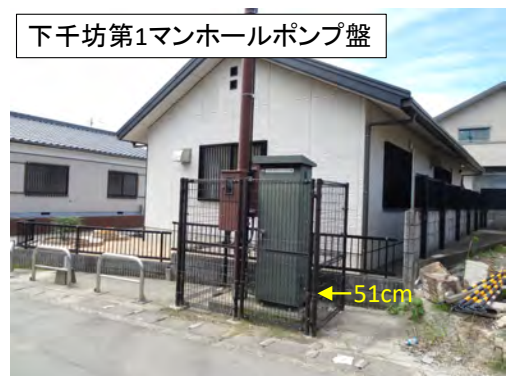
写真 3.2 下千坊第 1 マンホールポンプ盤の浸水痕跡
