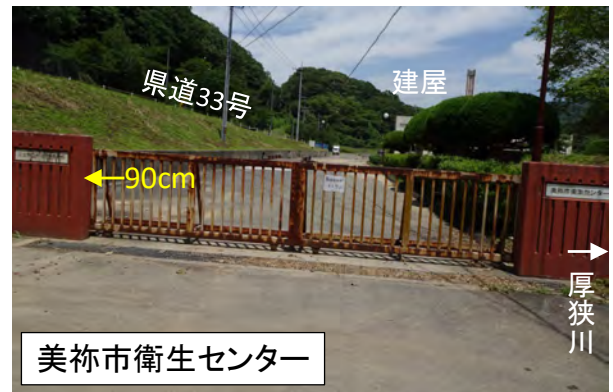
写真 4.7 美祢市衛生センターにおける浸水の痕跡
