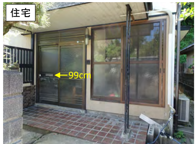
写真 3.3 住宅における浸水の痕跡（地盤からの高さ、cm）
