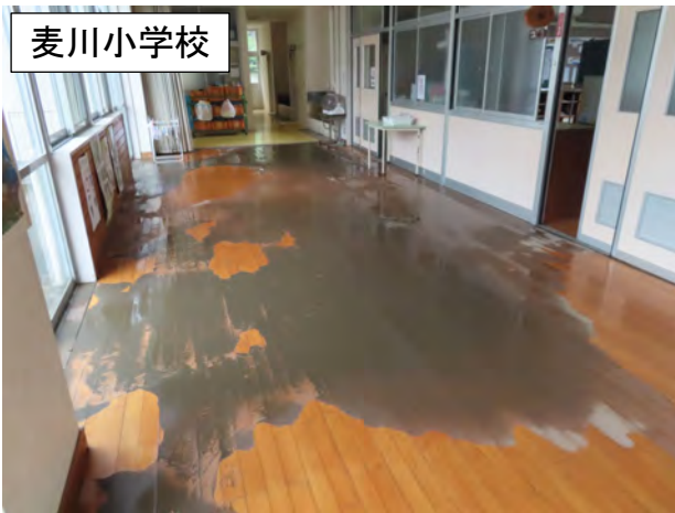
写真 2.7 麦川小学校における職員室（上）と廊下（下）の浸水被害（美祢市立麦川小学校、2023b）
