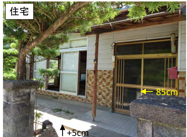
写真 5.16 住宅における浸水の痕跡（地盤からの高さ、cm）
