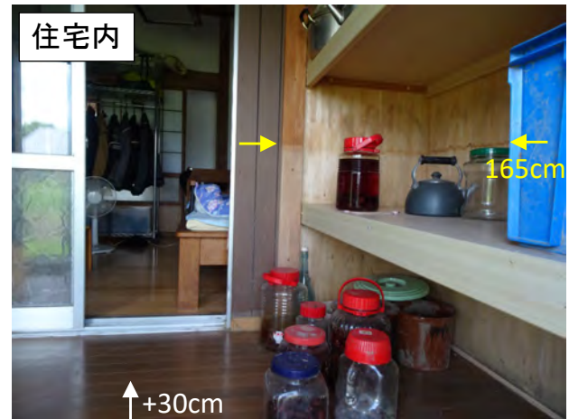
写真 5.11 写真 5.10 の住宅内における浸水の痕跡 (地盤からの高さ、cm)
