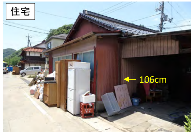
写真 3.2 住宅における浸水の痕跡（地盤からの高さ、cm）
