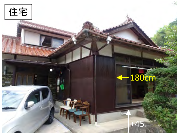
写真 5.12 住宅における浸水の痕跡 (地盤からの高さ、cm)
