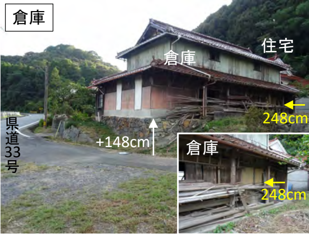
写真 5.7 倉庫 (B) における浸水深 (地盤からの高さ、cm)
