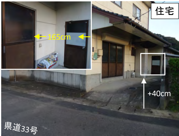
写真 6.2 住宅における浸水の痕跡（地盤からの高さ、cm）
