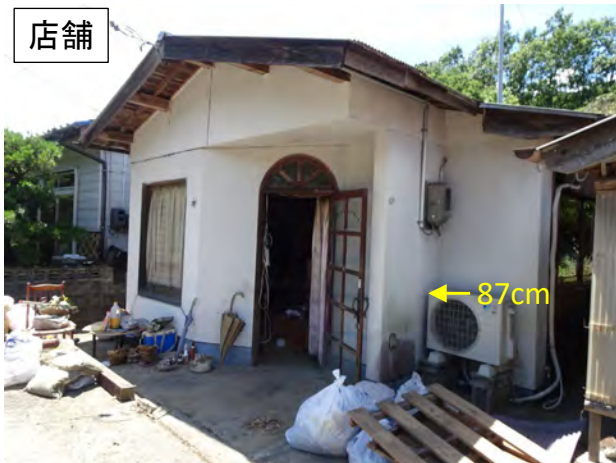
写真 5.15 店舗における浸水の痕跡（地盤からの高さ、cm）
