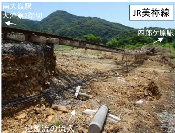
写真 4.6 JR 美祢線における盛土の流失被害（南大嶺駅—四郎ヶ原駅間）
