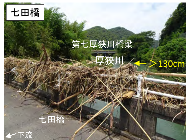
写真 4.5 厚狭川七田橋における欄干への塵芥付着
