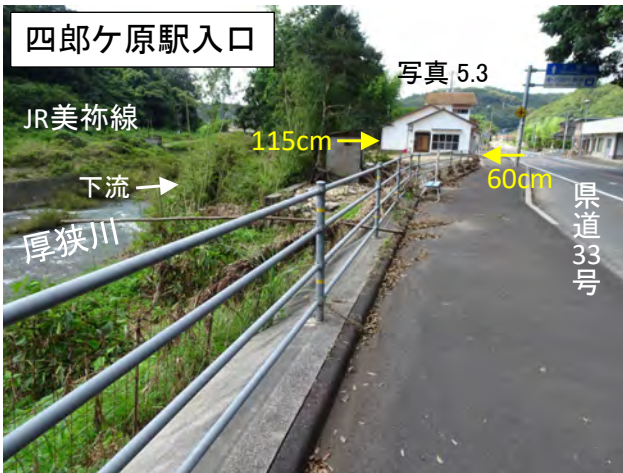
写真 5.2 県道 33 号の四郎ヶ原駅入口における浸水の痕跡 (地盤からの高さ、cm)
