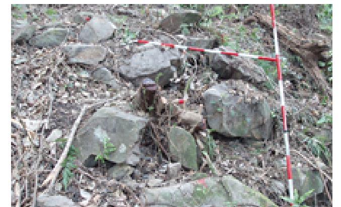
写真-1 下部斜面の転石状況
