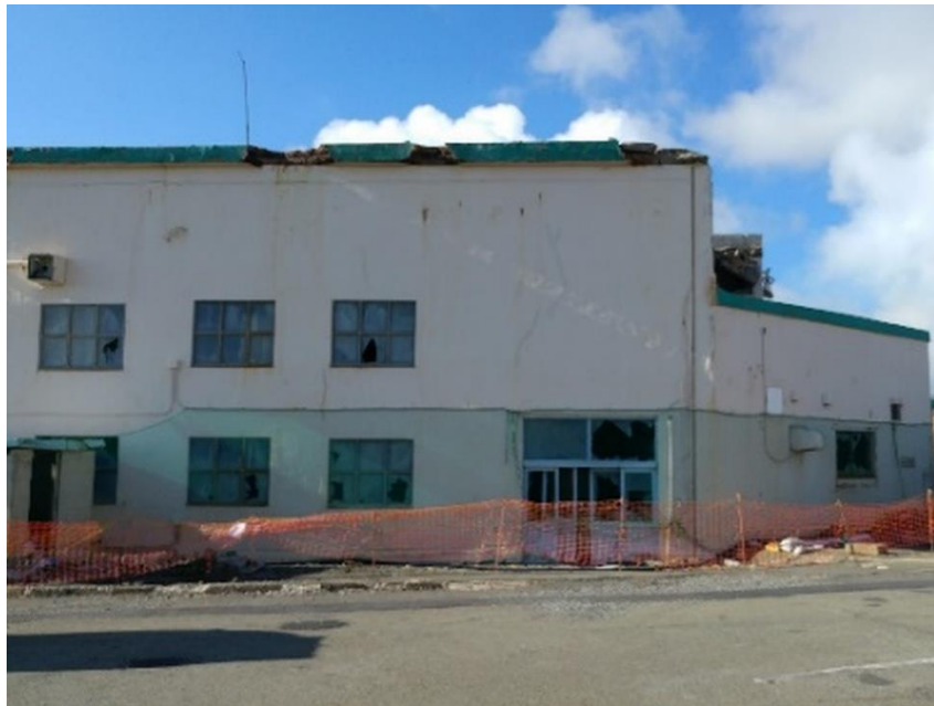
図3 中岳にある破壊された建物（熊本県阿蘇）
